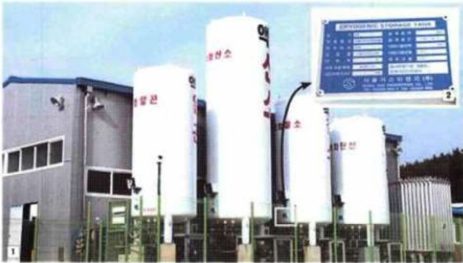
1. 서울가스이엔지가 명판을 위조해 납품한 초저온저장탱크가 반도체용합가스에 설치돼 있다. 대안군으로부터 시 설개선 명령 등 막대한 손상을 입은 반도체용합가스가 피해보상을 호소하고 있다. 2. 서울가스이엔지가 제조해 반 도용합가스에 설치된 절소저장탱크의 명판. 하지만 위조된 명판으로 인해 반도체용합가스에 시설개선 등 추가비용 의 손실이 발생했다.
