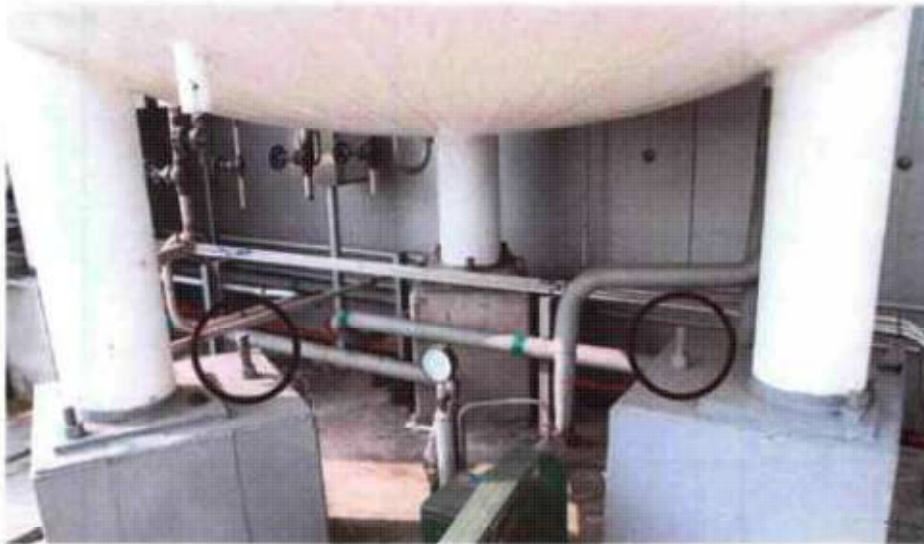
당초 계약한 단산지정탱크의 용량과 다른 크기의 제품이 반도종합가스에 도착해 영커볼트를 다시 박아 설치한 모습. 원래는 당초 설계용 영커볼트.
